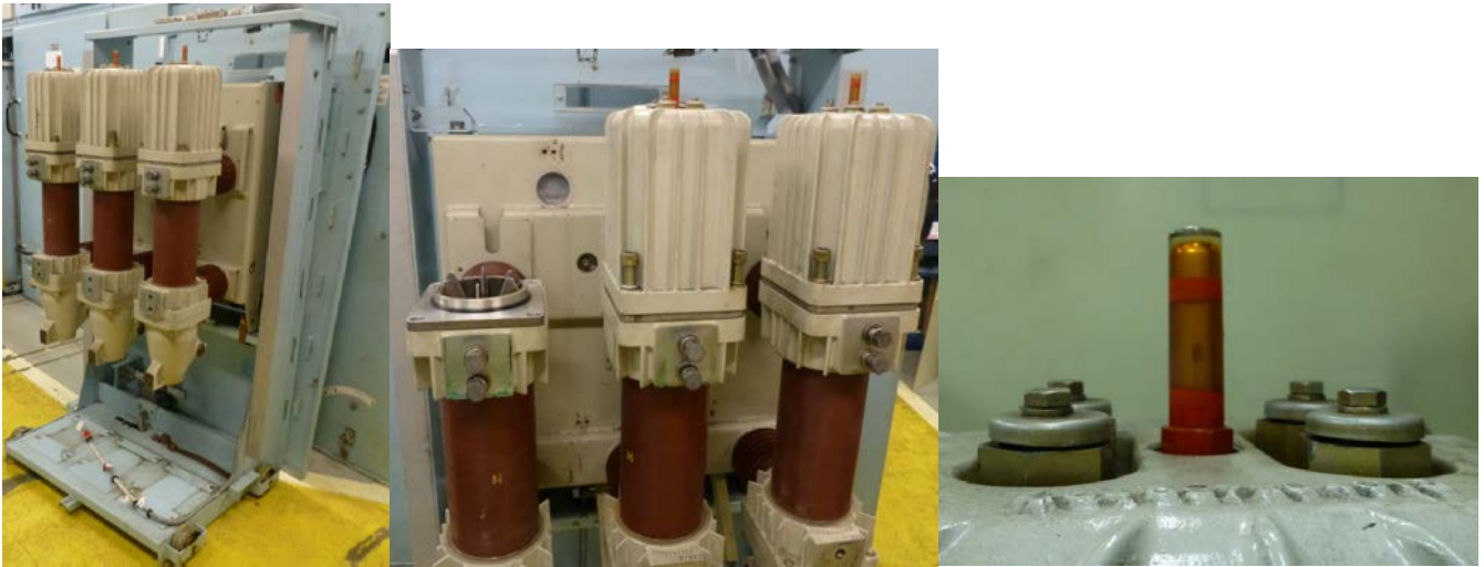
Figur 4-2 Bildene viser de oljefattige bryterkammerne på «innsiden» av brytervognen. På bildet i midten er toppen på den ene effektbryteren tatt av, bildet til høyre viser oljenivået i selve bryterkammeret
